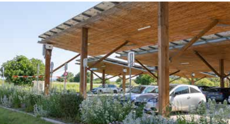
Le pôle d'échanges multimodal de Saint-Geniès-de-Malgoirès et ses ombrières photovoltaïques
